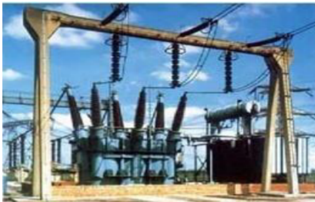
变电站的大型变压器
